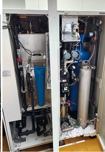
【写真2】水処理装置の内部
