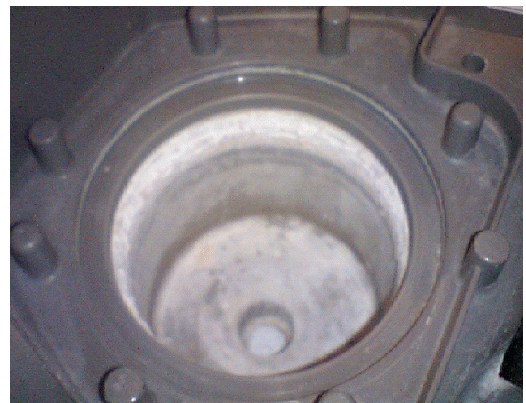
硬水が蒸発すると、含まれていた塩類が析出します。工業用ボイラーでは、加熱によって塩類（スケール、缶石、水垢など）がよばれています。が生じるため、熱効率を著しく低下させるといわれています。写真は加湿器の中に入ってきたスケールです。
